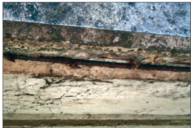
Bild 3.4: Korrodierte Bewehrung an der Kappe der Brücke (aus Bauwerksbuch)
