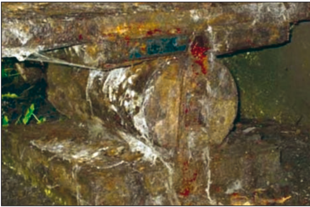
Bild 5.3: Stark korrodiertes Rollenlager (SCHNELLENBACH-HELD et al., 2013)
