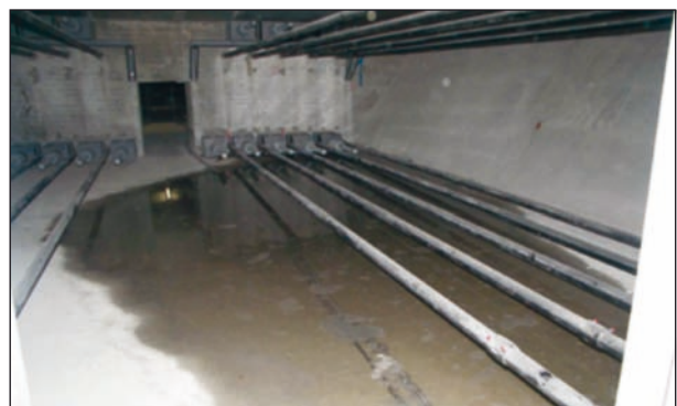
Bild 3.5: Flutung des Brückenkastens im August 2007 aufgrund undichter Besichtigungsluke (aus Bauwerksbuch)
