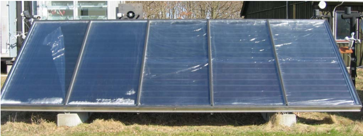
Figur 5. Solfangeren fra Ottrupgård i DTU Bygs prøvestand.
