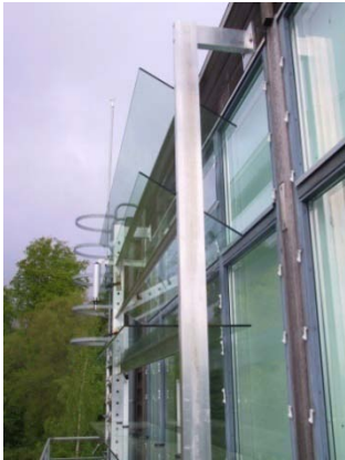
Figur 16. Dagslysdigerende glaslameller opsat ud for testrummet.
