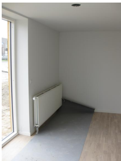
Figur 2 Foto af radiator i køkken-alrum i lavenergi bolig i Lystrup
