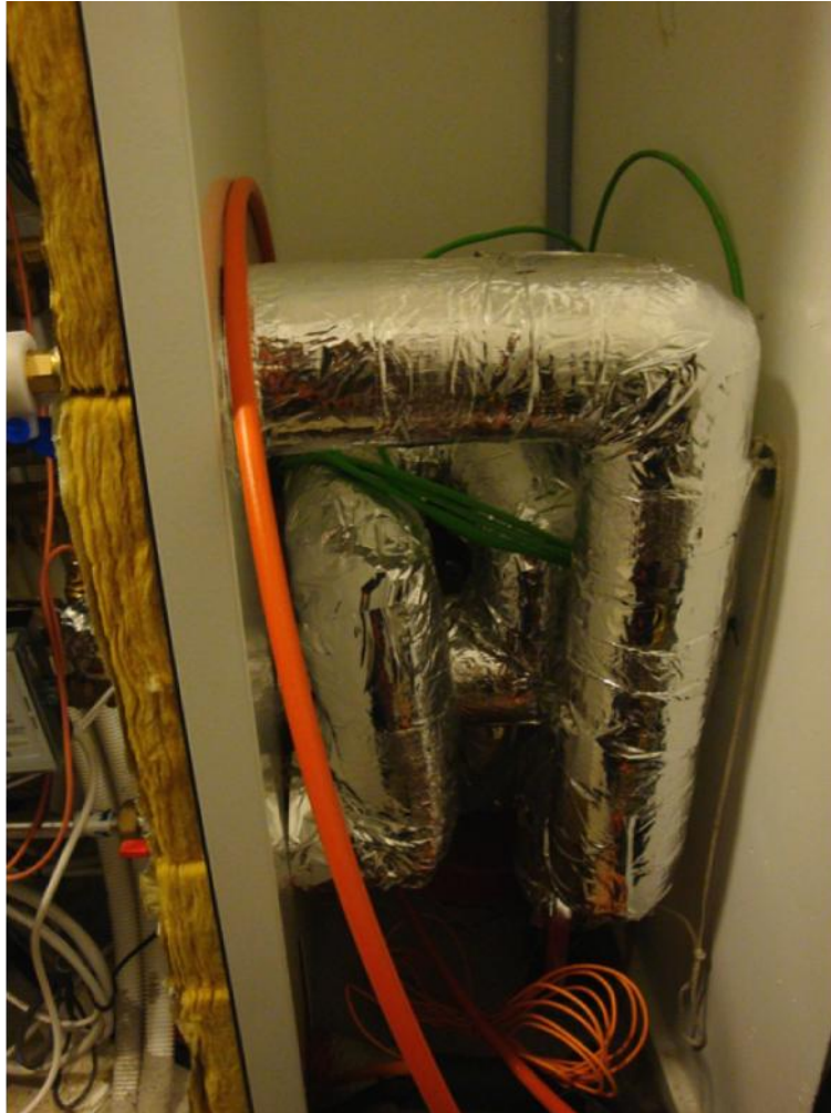
Figur 2 Isoleret rørføring før måler til FVB-units
