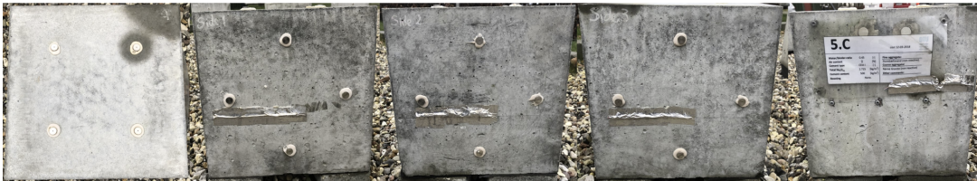
Figur 13: Overfladerne af blok 5.C.
