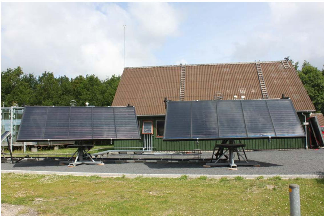
Figur 1. Sunmark solfangerne i DTU Bygs prøvestand for solfangere. Til højre den stationære solfanger og til venstre solfangeren i trackeren.
