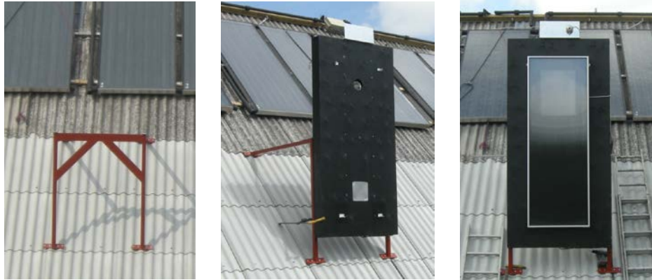
Figur 3. Foto af metalrammen (venstre), hele luftsolfangerprøvestanden (midt) samt prøvestanden med luftsolfangeren SV14 fra SolarVenti A/S og pyranometer monteret (højre).
