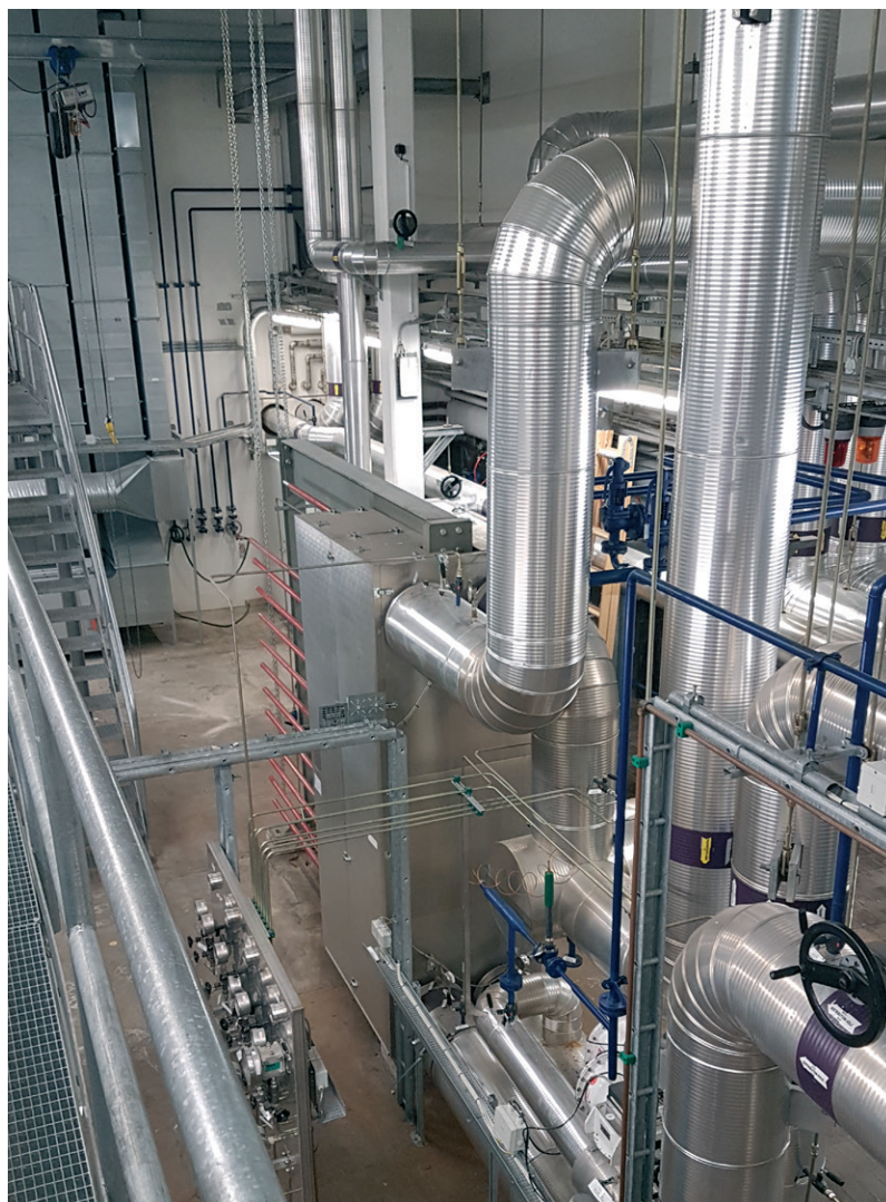
Denne forsynings- veksler udgør varme- kilden, der forsyner Tingbjerg-området i København med fjernvarme. Foto: HOFOR.
