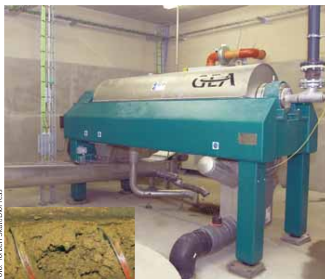
Dekantercentrifuge på Morsø Biogasanlæg. Indsat billede nederst til venstre viser den faste fraktion.
