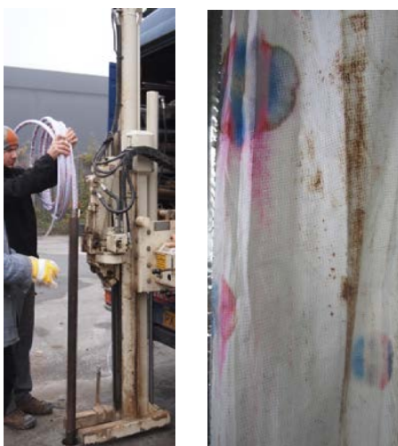
Figur 2: Installation af hydrofob fleksibel membran vha. Geoprobe (venstre) og farvemærkning på bagsiden af farvestribet membran som resultat af kontakt med DNAPL (højre).
