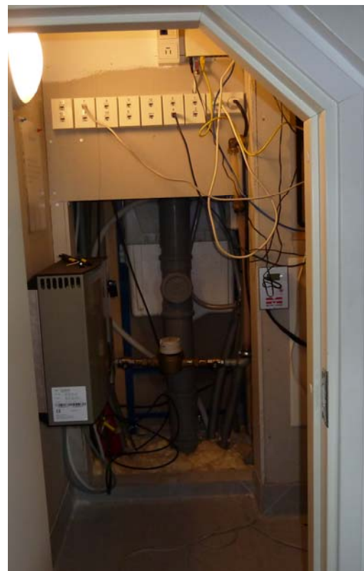
Figur 62 Installationsrum er placeret under trappe
