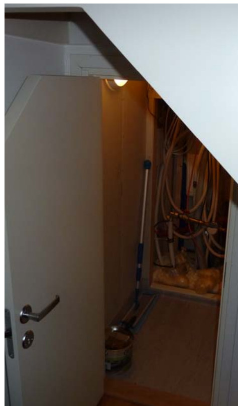
Figur 66 Teknikrum er placeret under trappe
