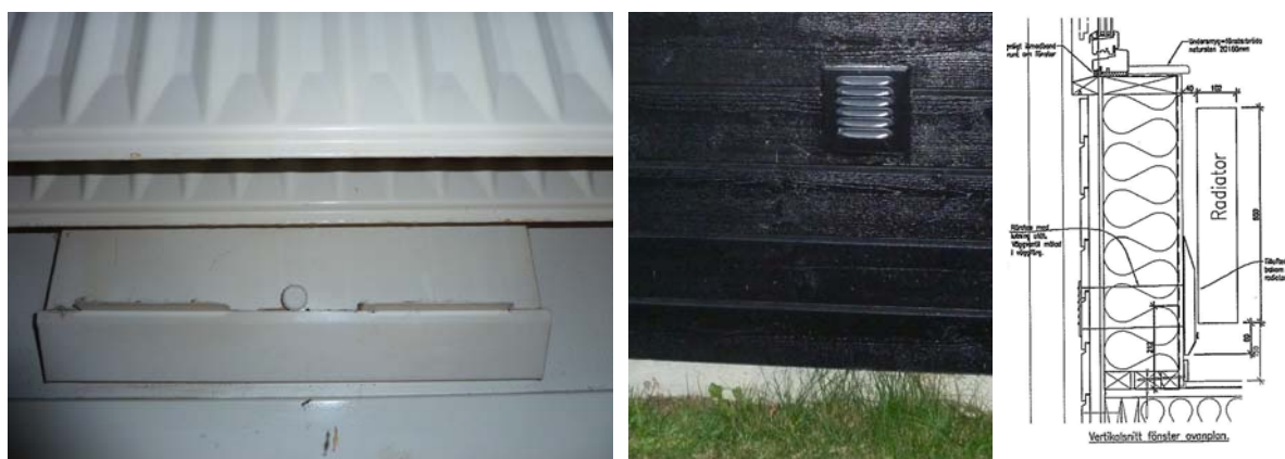
Figur 69, 70, 71 Ventil med tvangsventilation bag radiator Boklok Hillerød
