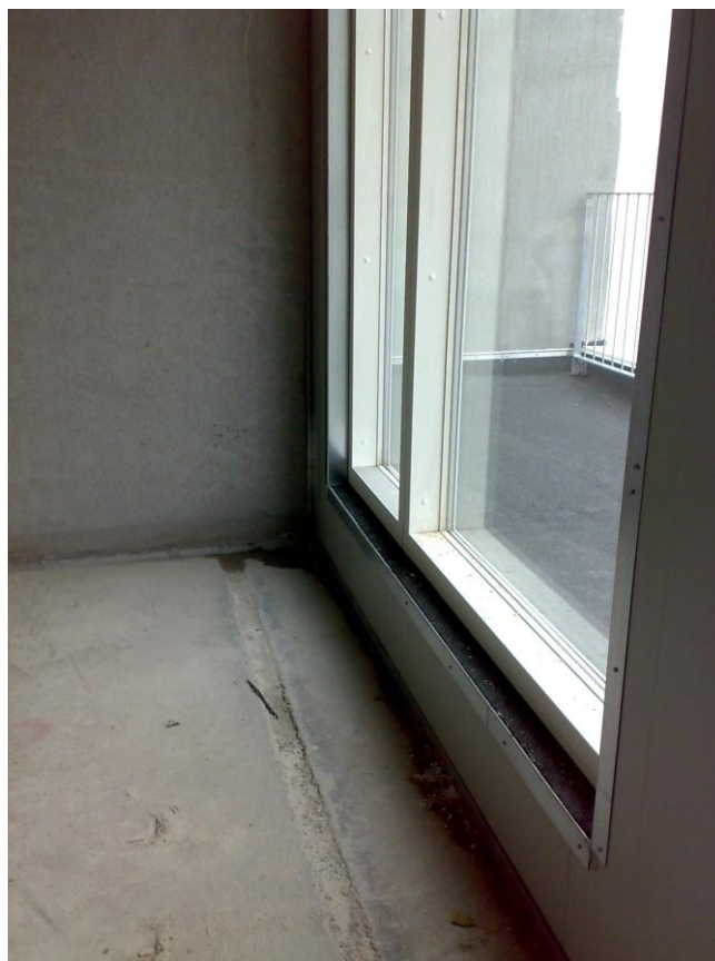
Billede 13: Efter et stort regnskyl er der vand i penthouse [6. august 2008].
