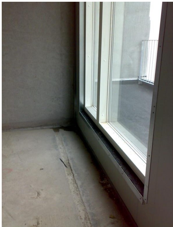
Billede 5: Efter et stort regnskyl er der vand i penthouse [6. august 2008].
