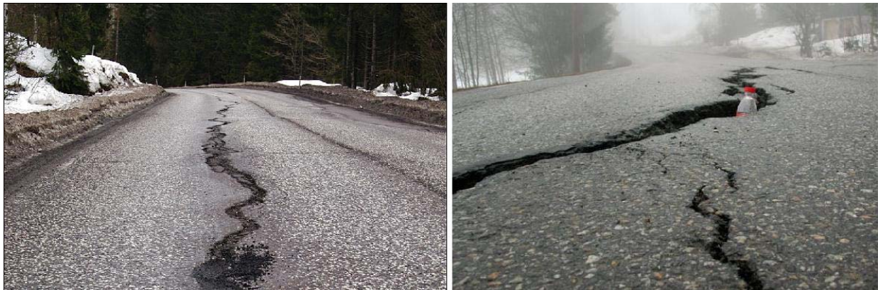
Figure 4-2 Examples for cracking in Norway [ http://www.vg.no/bil-og-motor/artikkel.php?artid=584406 and http://www.abcnyheter.no/nyheter/100408/veiene-verre-enn-pa-mange-ar ]
