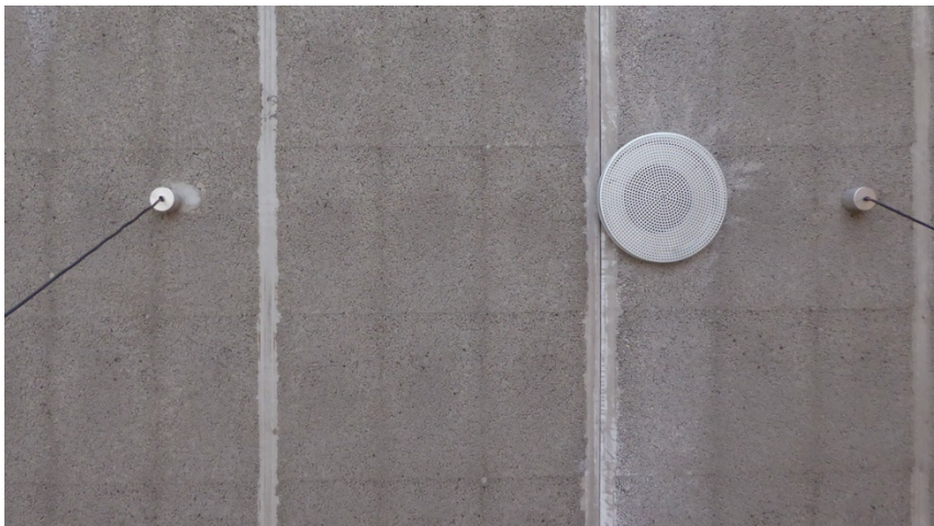
Figur 3.4.5.2. Overflade af lydabsorberende SL-dæk i loft. Foto: K. Hertz.
