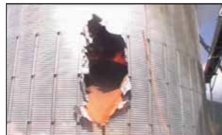
Siloens væg brydes op for at få træpillerne ud. Der er en tydelig overfladebrand i midten af siloen.
