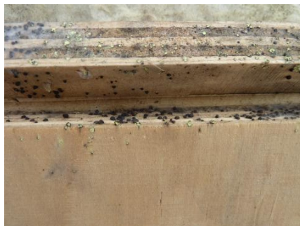
Skimmel i ventileret skunkrum
