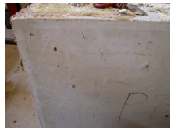
Figur 4.16. Foto af brandpåvirket overflade af vægelement med betontype P7.
