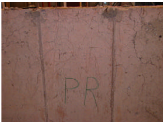
Figur 4.13. Foto af brandpåvirkede overflade af vægelement af beton PR
