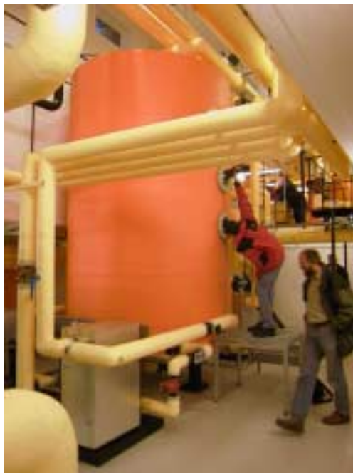
Figur 8. Inspektion af varmtvandsbeholder.
