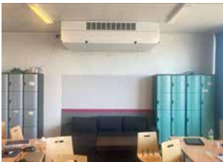
Figur 1. Det decentrale ventilationsanlæg monteret under loftet i det ene klasselokale.
