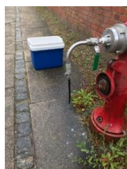
Figur 9: Prøvetagningshane anvendt i ledningsnettet i Herlev Nord og ved Vestre Kirkegård i København (HOFOR) til feltundersøgelser af migration fra PE-rør.
