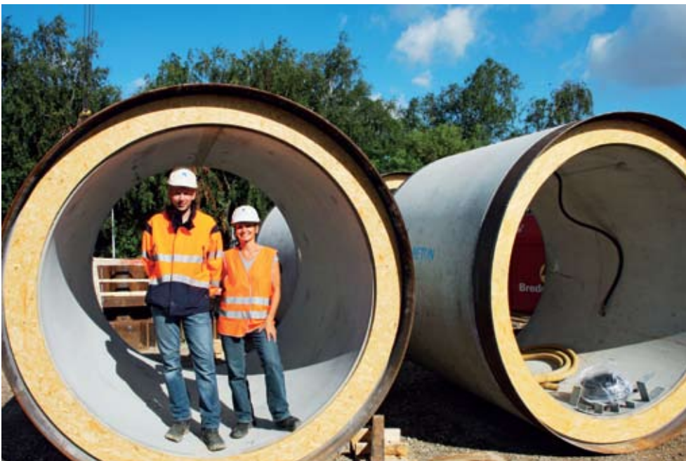
Som en del af klimatilpasningen har Odense Vandselskab brugt rør på helt op til 2,5 meter i diameter.
