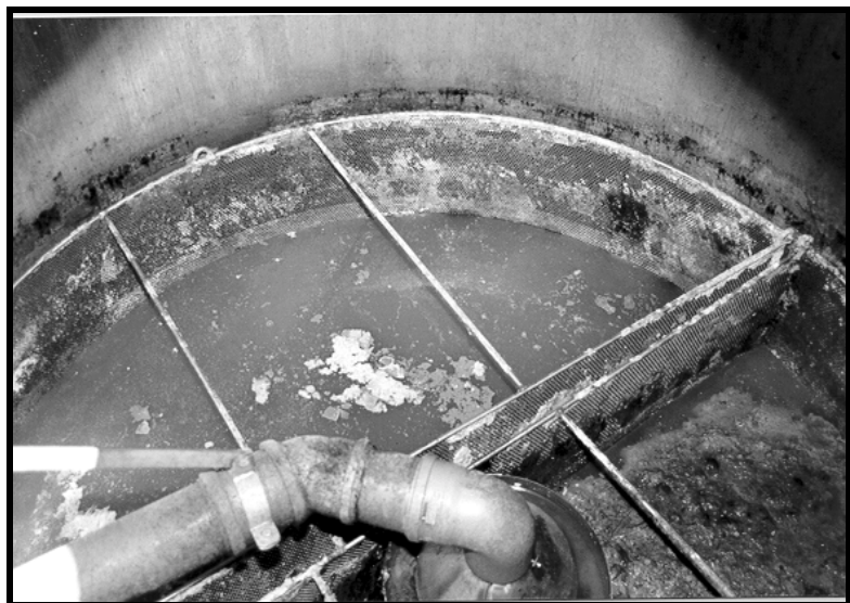
Kompostfanget er som hele systemet til behandling af sort og gråt spildevand voldsomt overbelastet
